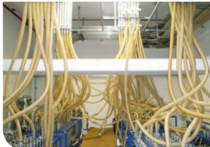
Verteilstation (Schlauchbahnhof), Weiterleitung des Rohstoffes zur Granulattrocknung
